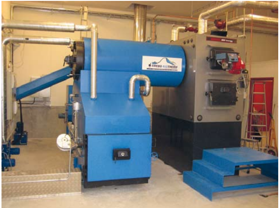
Swebo Bioenergys provanläggning, för eldning av svårare bränslen, som används i delprojekt B och H.
